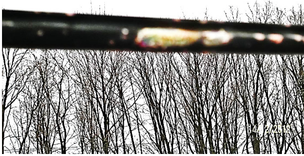
Рис. 4. Стан контактної провуду струмоведучого елемента на першому ізолюючому спряженні нейтральної вставки
